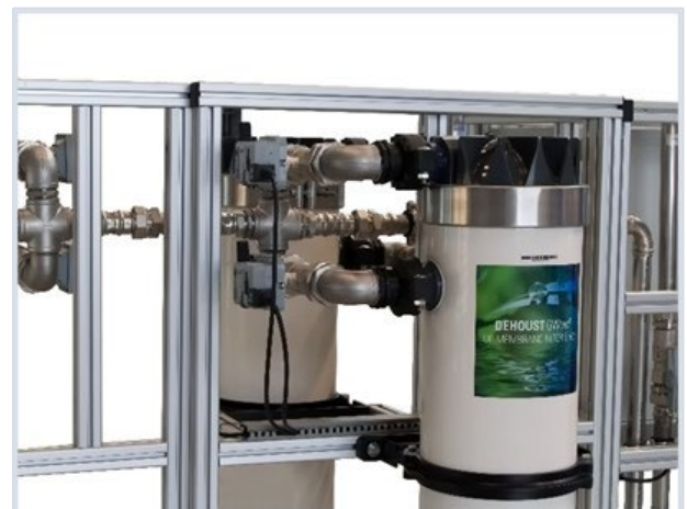
Abbildung 3: Anschlüsse Filter oben
